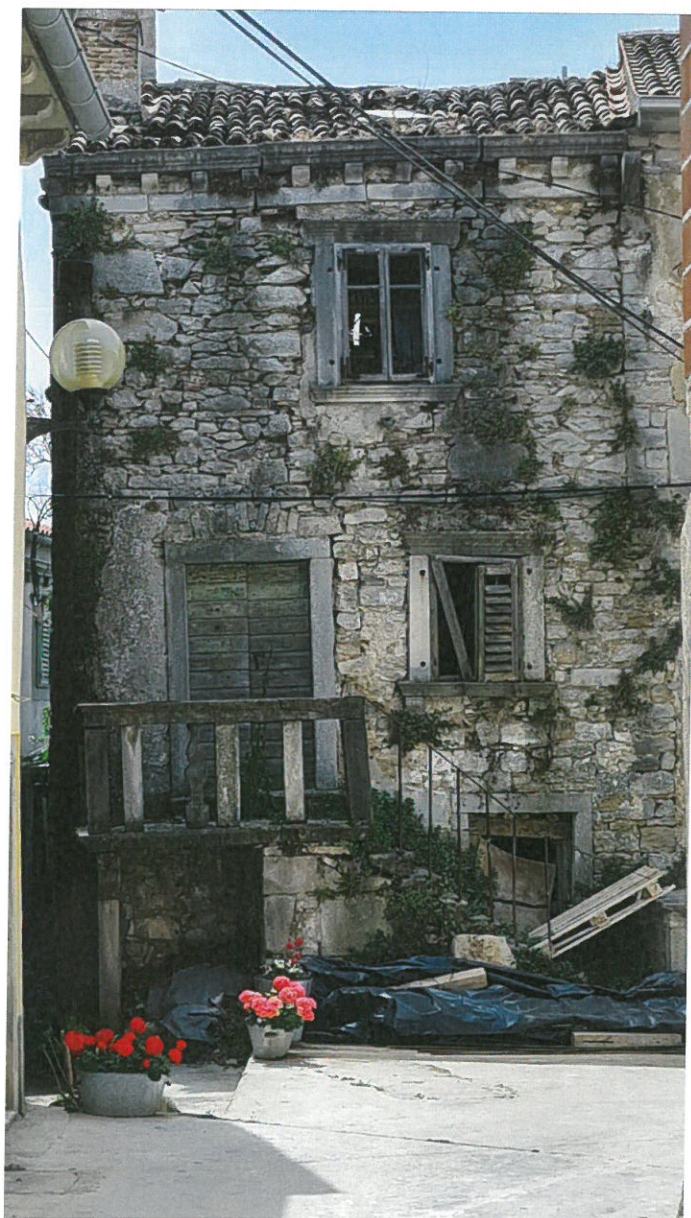
k.č.280 k.o. Labin-Presika zgrada- ruševina detalj krova
